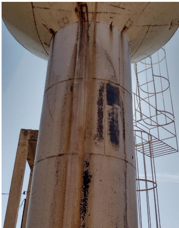
Figura 3 - Vazamento existente do reservatório e formação de bolhas
