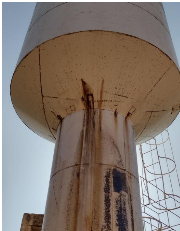
Figura 2 - Vazamento existente e formação de bolhas
