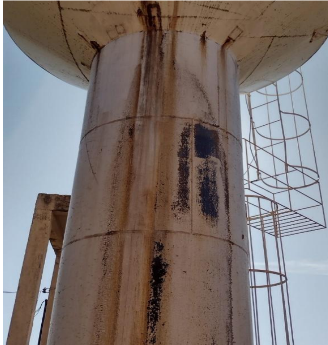
Figura 1 - Vazamento existente do reservatório e formação de bolhas
