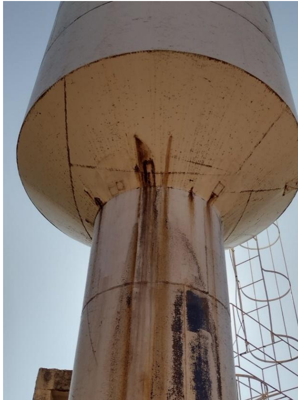
Figura 4 - Vazamento existente e formação de bolhas
